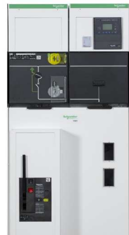
КРУ 20 KV : Schneider SM6
