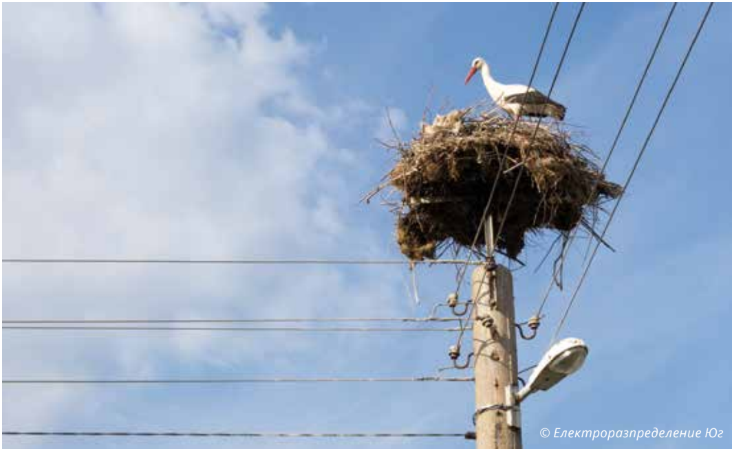
Монтирана платформа за щъркелово гнездо. Чрез нея гнездото се повдига на безопасно от проводниците разстояние.
